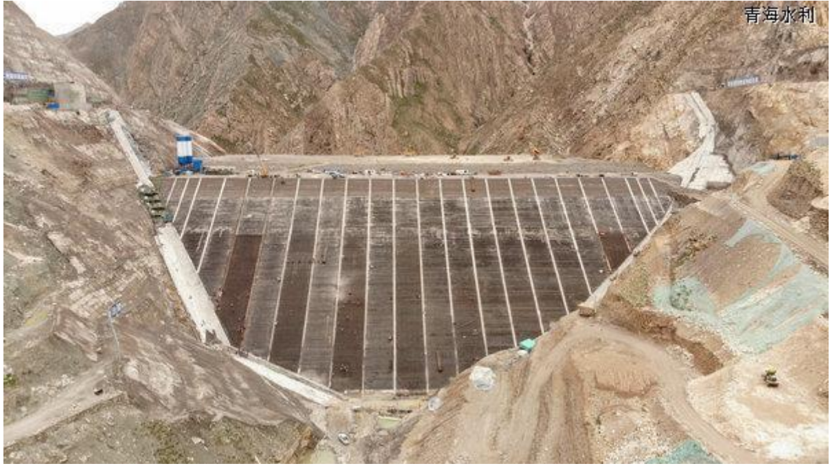
更是继往开来的美好明天—续集峡水利枢纽工程在建高峰期
